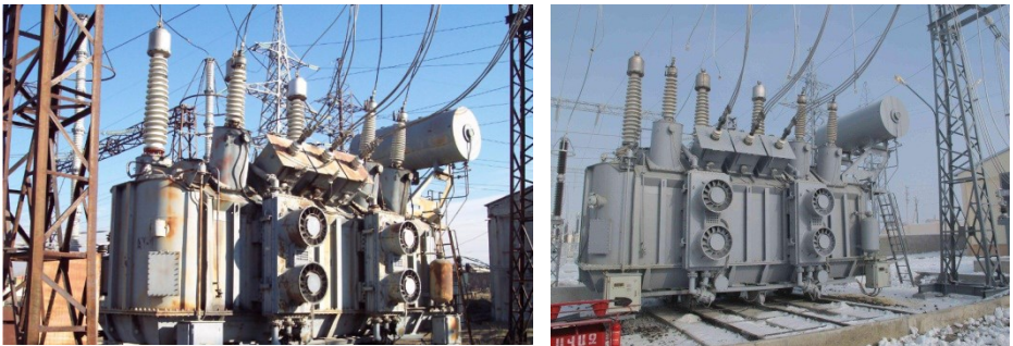
Abbildung 1 Umspannstation in Gyumri vor und nach der Rehabilitierung
